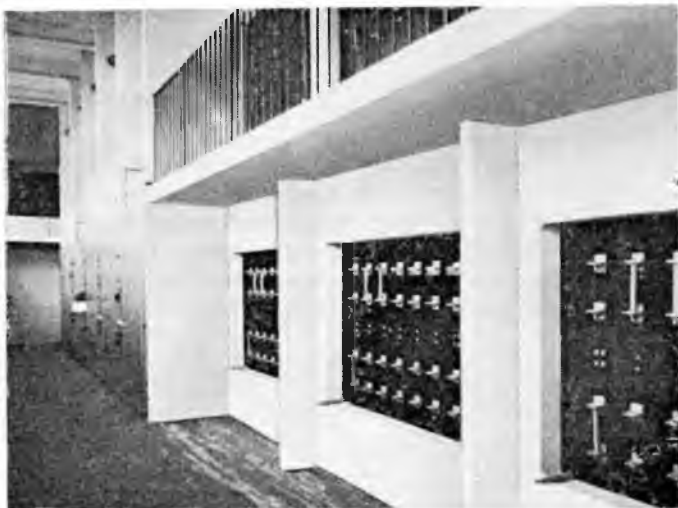
16-5. ábra. 10 kV-os kapcsoló- és szabályozóberendezés
